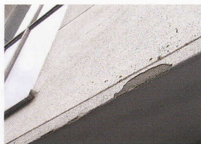
Feuchtigkeitsschäden, die auf eine unkontrollierte Wasserführung zurückzuführen sind
