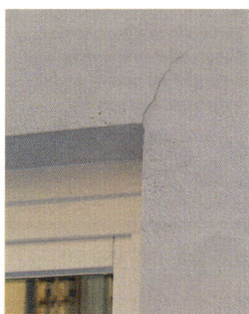
Eine fehlende Diagonalbewehrung führt zu Kerbspannungsrisse.
