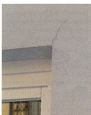
Eine fehlende Diagonalarbewehrung führt zu Kerspannungsrissen.
